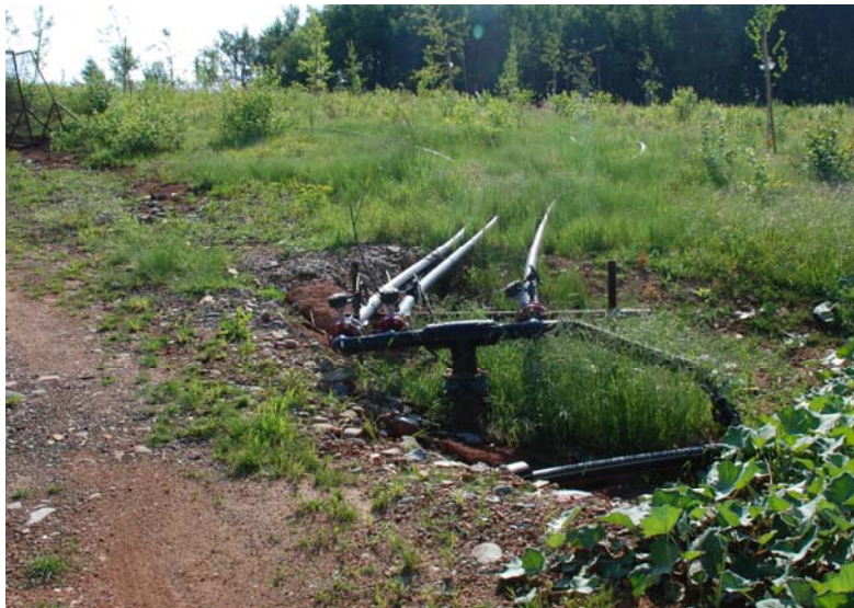
Collettore raccordo pozzi DU1, DU2, B14
